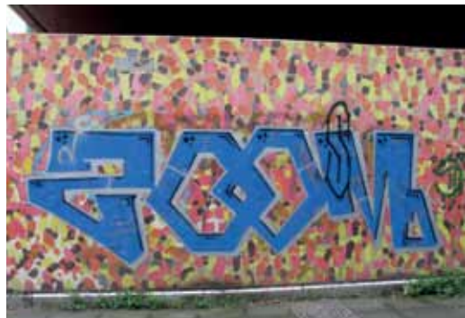
Zoom hat sich unter anderem am schon seit einigen Jahren nicht mehr genutzten Standort des Diesterweg-Gymnasiums verewigt.
